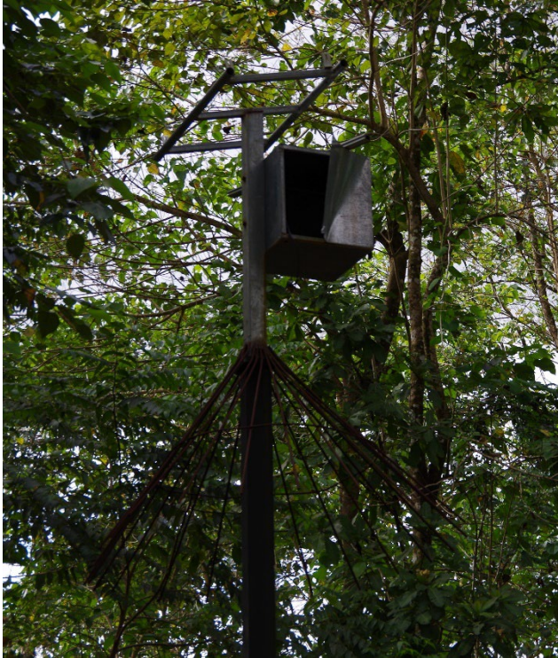
Restos de la instalación del panel solar
