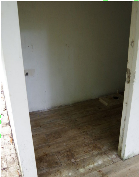
Robo de puerta y Servicio Sanitario
