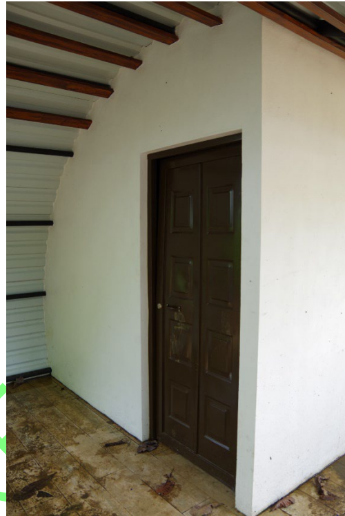
Daños materiales por intento robo
